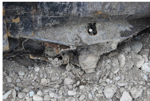
9(d) Bottom outlet valve
