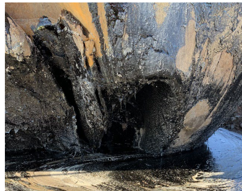
2(d) B-end left side breach.
